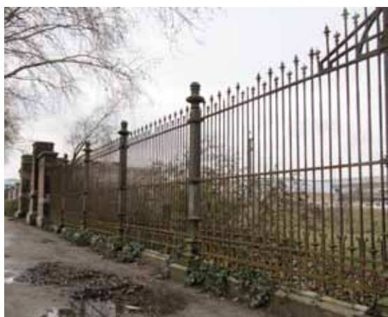
Série de cinq grilles hautes, avenue du Port, non entretenues, 2010.
