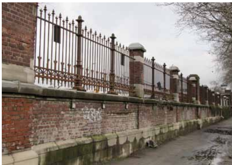
Série de six grilles sur mur, avenue du Port, non entretenues, 2010.
